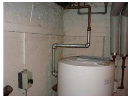
Altbau: Ölkessel mit Boiler. Einsparung durch Weglassen Dämmung CHF 200.00 Mehrverbrauch in 25 Jahren CHF 700.00
